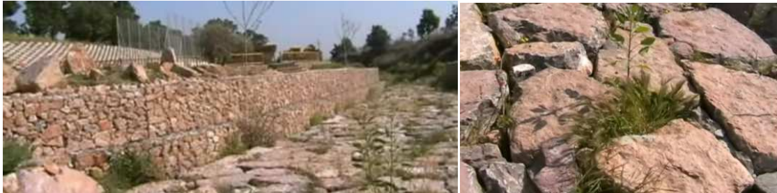
Detalle del encachado de piedra que armoniza con los gaviones en los taludes y enriquece paisajísticamente el entorno.
