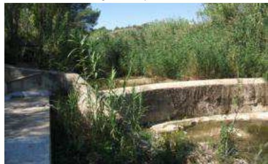
Azud de derivación del Caudal del Río Mula
