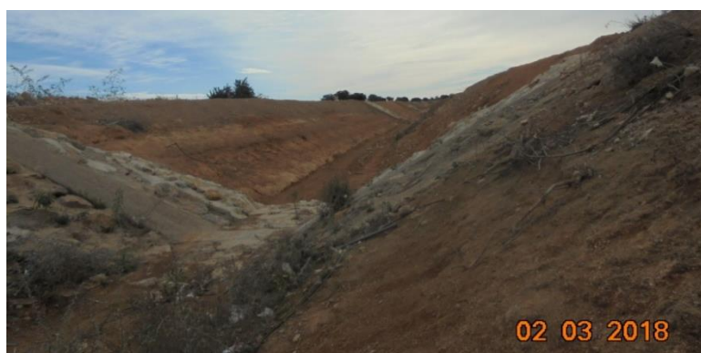
Figura 137: Ejemplo de tramo con encauzamiento y rastrillos en la Rambla del Albujón (entre el Canal del Campo y Pozo Estrecho).
