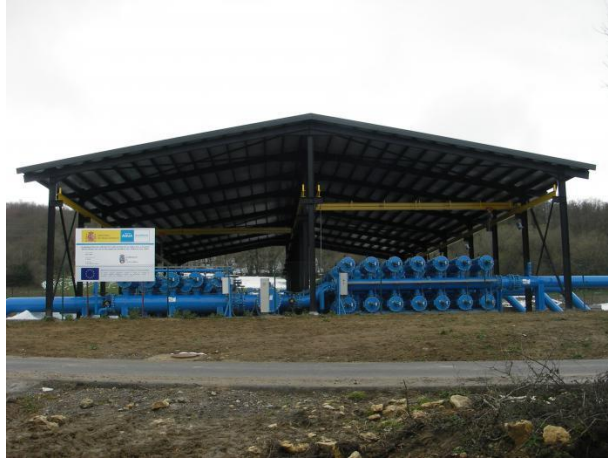
Planta filtración Ebro-Besaya (fuente: https://www.acuaes.com/actuacion/planta-de-filtrado-del-trasvase-reversible-ebro-besaya )
