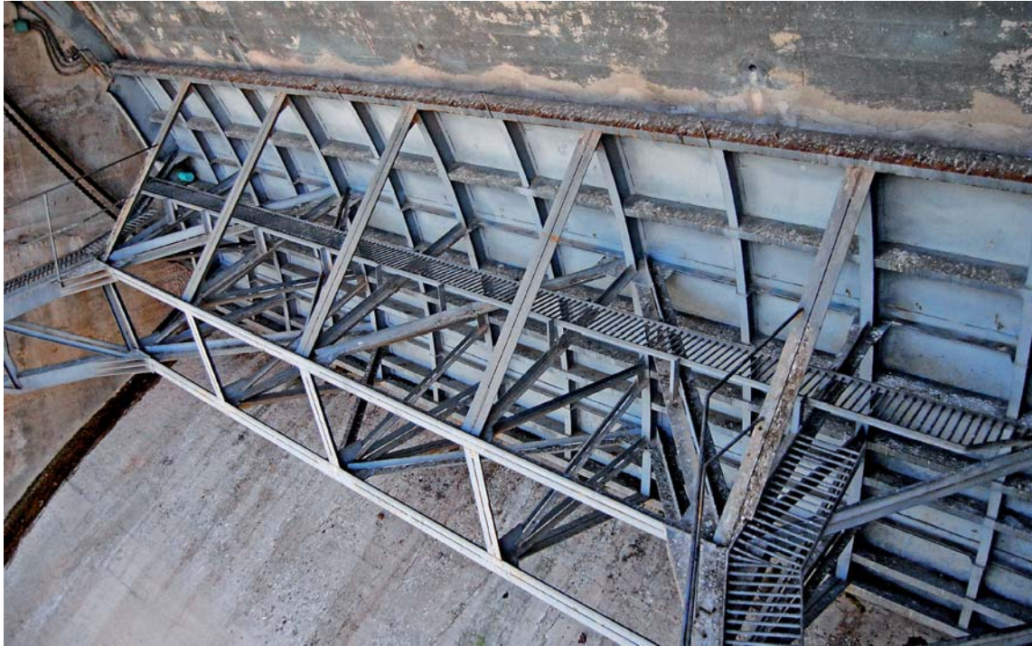
Compuerta Taintor del aliviadero del embalse del Cenajo.
