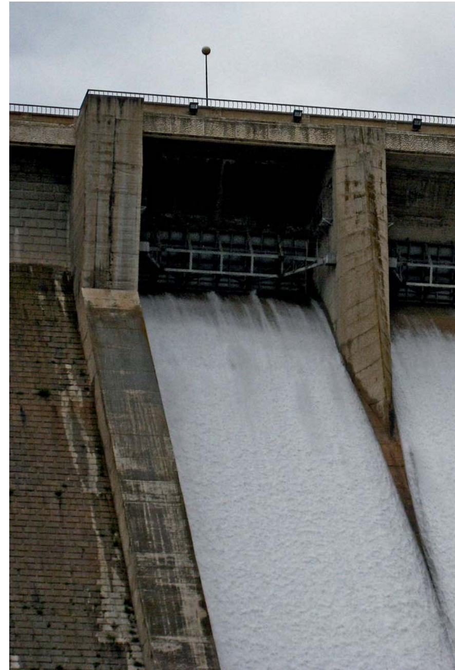
Compuertas del aliviadero de la presa del Cenajo desembalsando agua de forma regulada.
