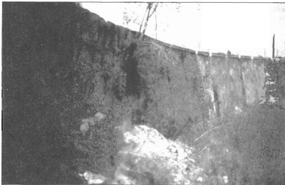
Fig. 62.- Protección de la carretera Cartagena-Isla Plana. (Rambla de Benipila)
