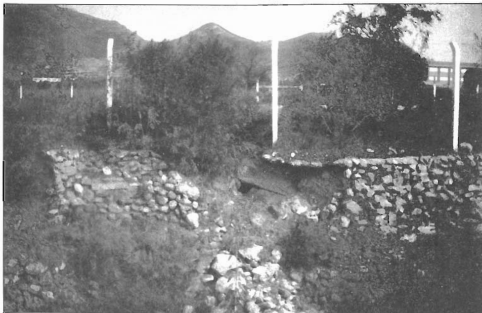
Fig. 63.- Boquete abierto en muro de revestimiento. (Rambla de Peñas Blancas, junto al Saladillo)
