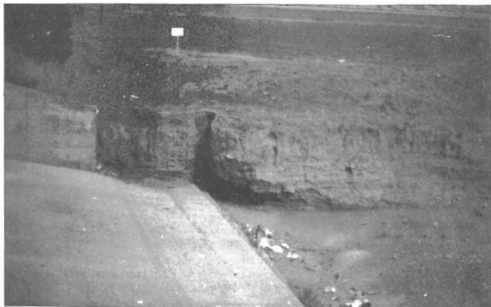
Fig. - 48. Socavación ligada a excesos de presión hidroestática por efecto de las cimentaciones en la base de un margen limo-arcilloso. Rambla de la Carrasquilla
