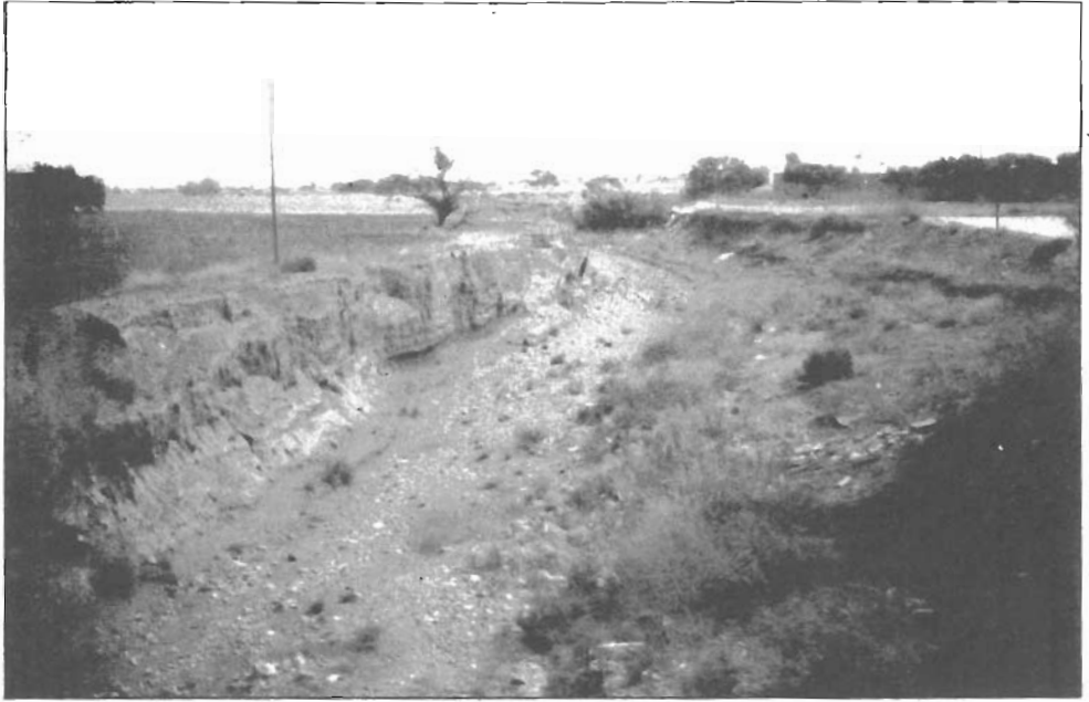
Fig. - 49. Derrumbes en margen no cohesivo de fuerte ángulo de fricción (m-iz) (Rambla de Carrasquilla)
