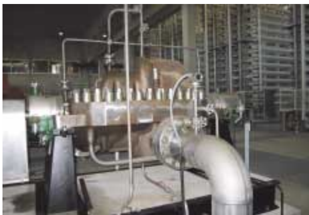
Desaladora de San Pedro I
