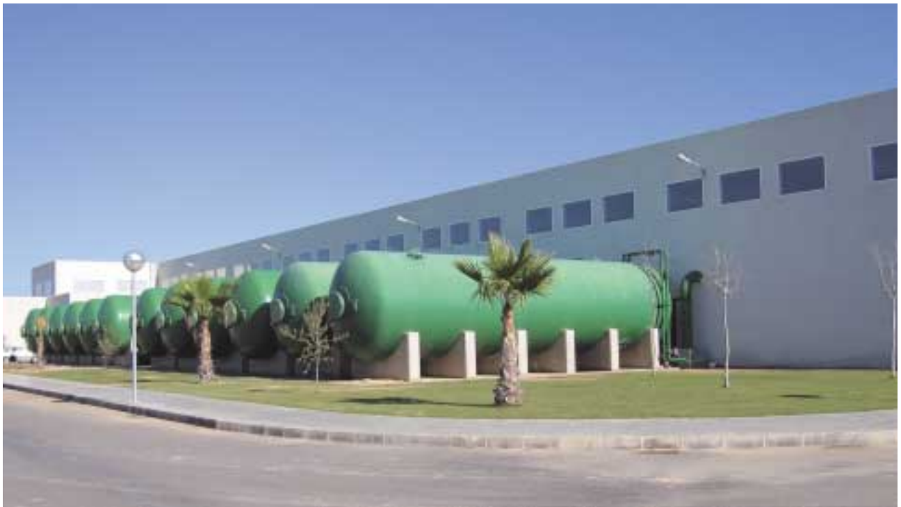
Desaladora de San Pedro I
