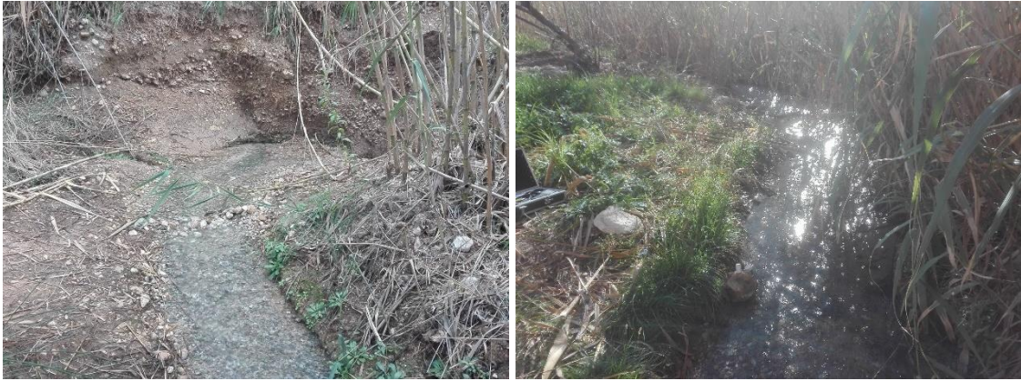
Figura 2.55. Fuente del Chícamo. La sección de aforos que se construyó en 2008 ha sido destruida por las crecidas producidas por las lluvias torrenciales de los últimos años.
