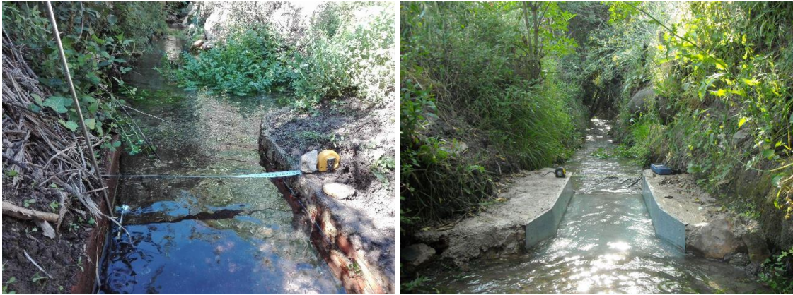
Figura 2.63. Fuente Molino Guarina. La sección de aforos instalada necesita reparación.
