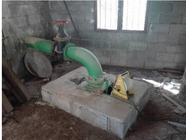
Figura 2.115. Pozo Somogil. En este pozo solo se realizará un control piezométrico. Se sitúa a escasos 15 m del manantial de Somogil. Este pozo secó el manantial durante un periodo de tiempo.
