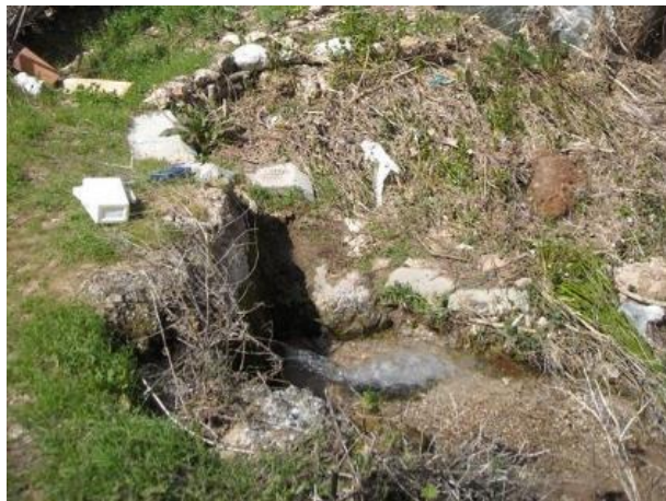
Figura 2.15. Fuente Molino del Río Madera. Aforo volumétrico
