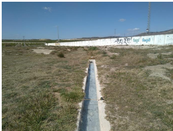
Figura 2.76. Fuente de Yéchar. El agua se aprovecha directamente para riego, por lo que debe aforarse cuando no hay derivación para este uso.
