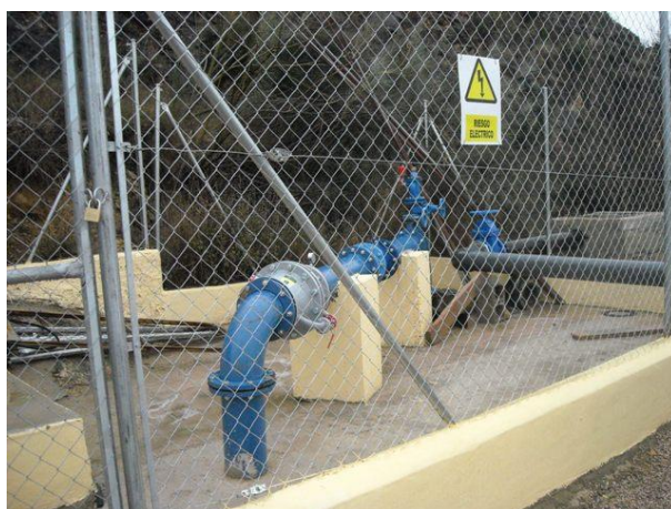
Figura 2.111. Pozo SAT La Raja. Pozo de uso agrícola, situado justo donde se encontraba el nacimiento de la Fuente de La Raja. El pozo permitirá tener un nivel piezométrico de la zona oriental del acuífero.
