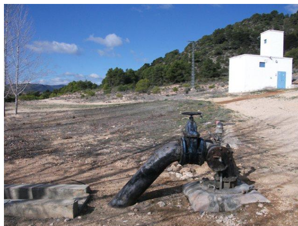
Figura 2.108. Pozo Finca Gorrafiná. Se trata de un pozo situado al norte del acuífero Revolucionadores con un uso agrícola. Se solicitará datos de explotación.
