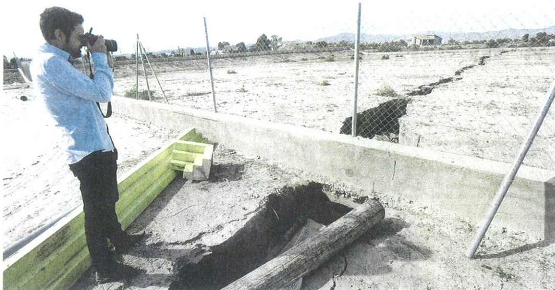
Un joven fotografía, ayer, la grieta que atraviesa varias fincas en la diputación de El Esparragal. :: PACO ALONSO / AGF
