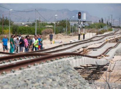
Detalle de los daños en la vía. Sentido del flujo de margen derecha a izquierda.
